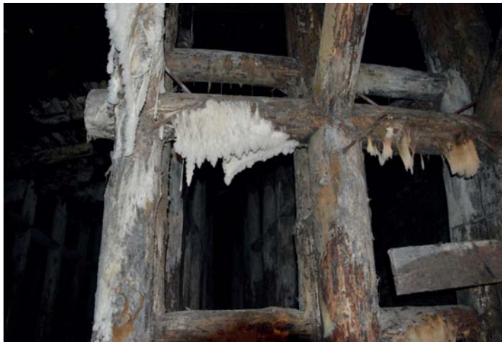
Rys. 14.6. Przedmiotowa konstrukcja obudowy z grzybnią grzyba Poria vaillantii (grzyba domowego białego) – fot. W. Skowroński
