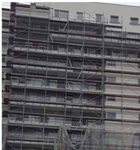
Rys. 3.155. Przesunięcie części pionu komunikacyjnego (w lewo od zastosowanego w niższych kondygnacjach) na rusztowaniach o wysokości ponad 20 m
